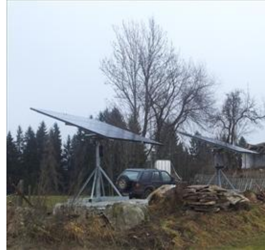
18m 2 2 Suntracker 2000R/4kWp
